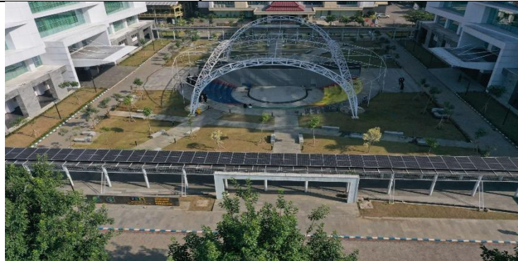
F. Panel surya di GKB dengan energi total
