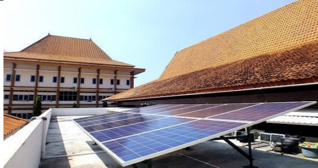
E. Panel surya untuk listrik laboratorium
